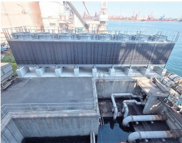
2023年5月に設置した冷却塔
