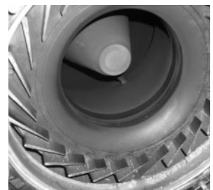
写真4 過給機 ノズルリング(未洗浄)
