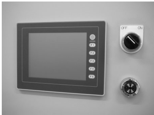
図-1 操縦盤組み込み状態
