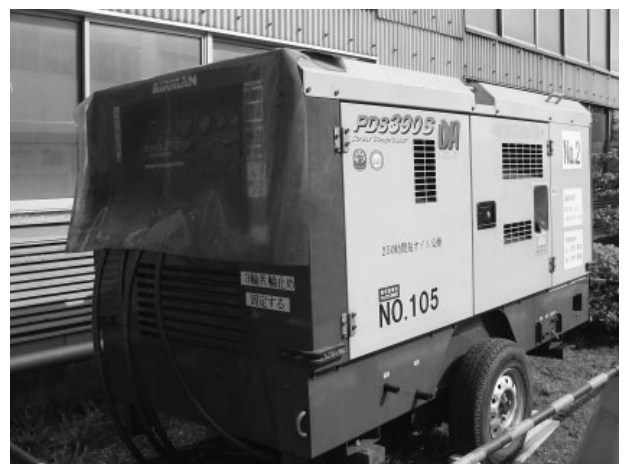
設置したエンジンコンプレッサー
