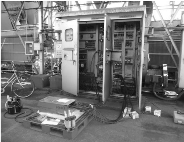
電力検証時の様子
