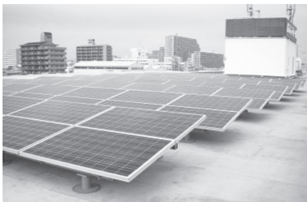
設置済みの発電用パネル
