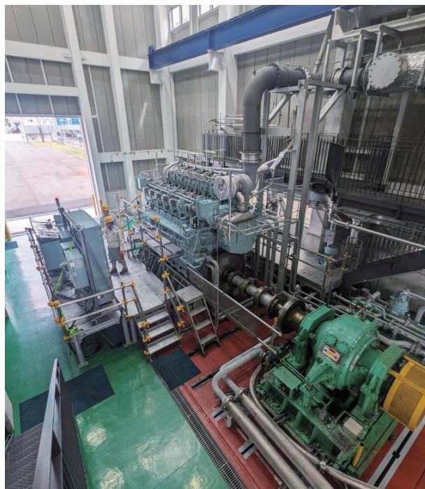
LA28M形機関運転設備
