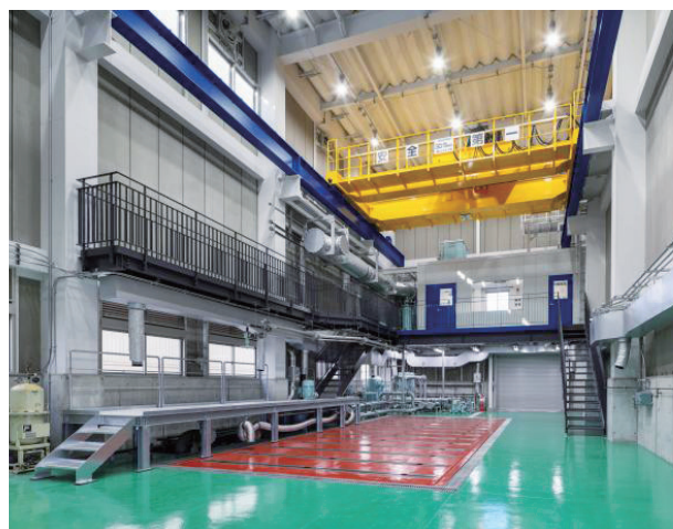
新運転設備（高度研究棟）
